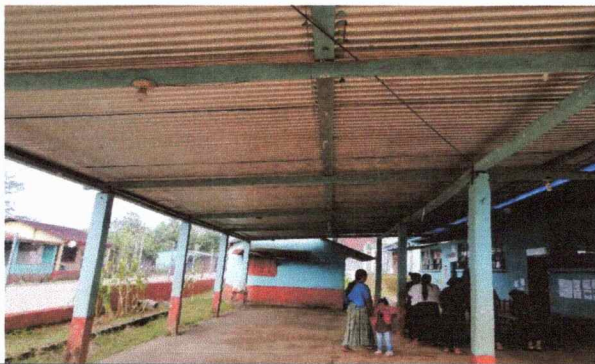
Foto 3: La madera se encuentra dañada por filtraciones de agua en el módulo 2.
