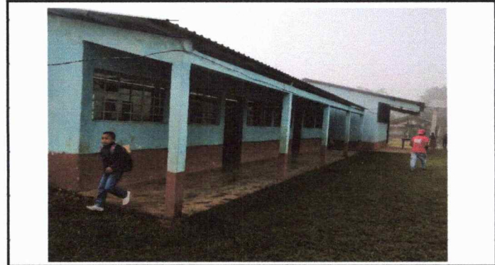
Foto 2: Se observa deterioro de la pintura y humedad en el módulo 4.
