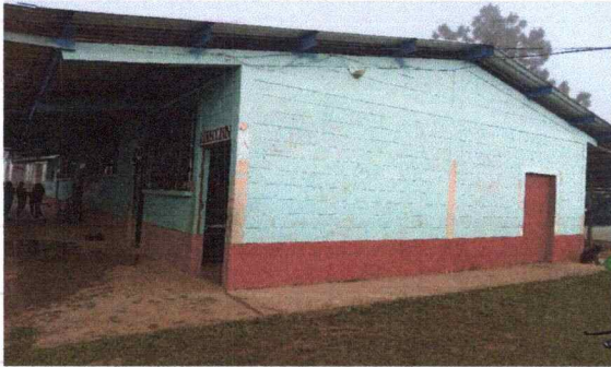
Foto 1: Se observa deterioro en las paredes, desprendimiento de la pintura en las paredes del módulo 1.
