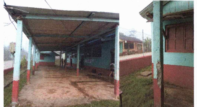
Foto 4: Se observan daños severos en las columnas de concreto del módulo 2.
