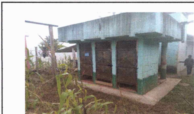
Foto 1: Se observan daños en las puertas y desprendimiento de la pintura en el módulo 7
