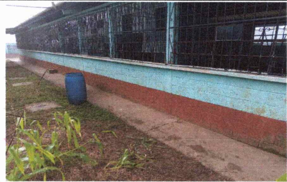
Foto 2: Se observan daños en las paredes por humedad y desprendimiento de pintura en el módulo 1.
