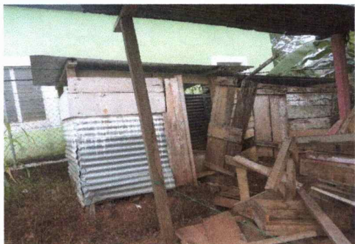
Foto 3: Se observan daños irreversibles en paredes y losa sanitaria en el módulo 8
