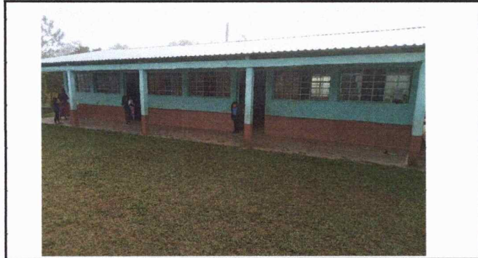
Foto 1: Se observan daños en la paredes y desprendimiento de la pintura en el módulo 4
